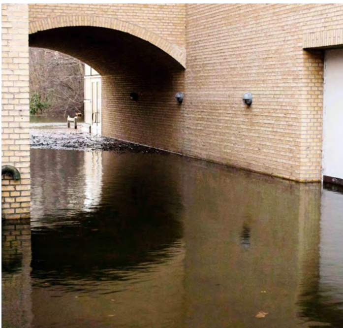
Stormen Bodil forårsagede oversvømmelser på blandt andet Frederiksværk Gymnasium
