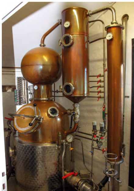
Det nye destillationsapparat. Destillationsapparatet er specielfremstillet, idet det skal passe i de lavloftede bygninger, som tidligere har været en kyllingefarm
