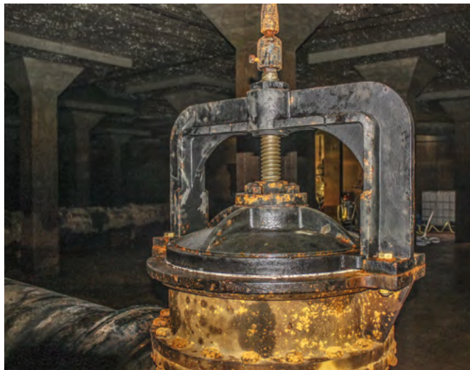
En af de oprindelige ventiler. Det er imponerende, hvad man kunne præstere i 1937
