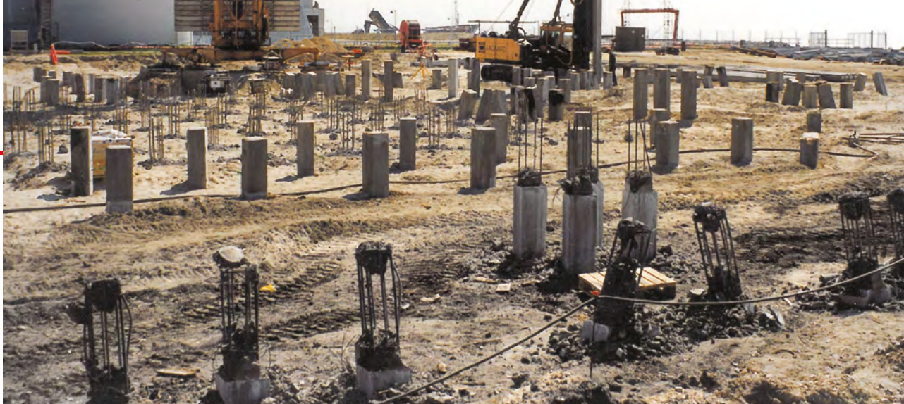
Sprængte pæle på Avedøreværket 1999
